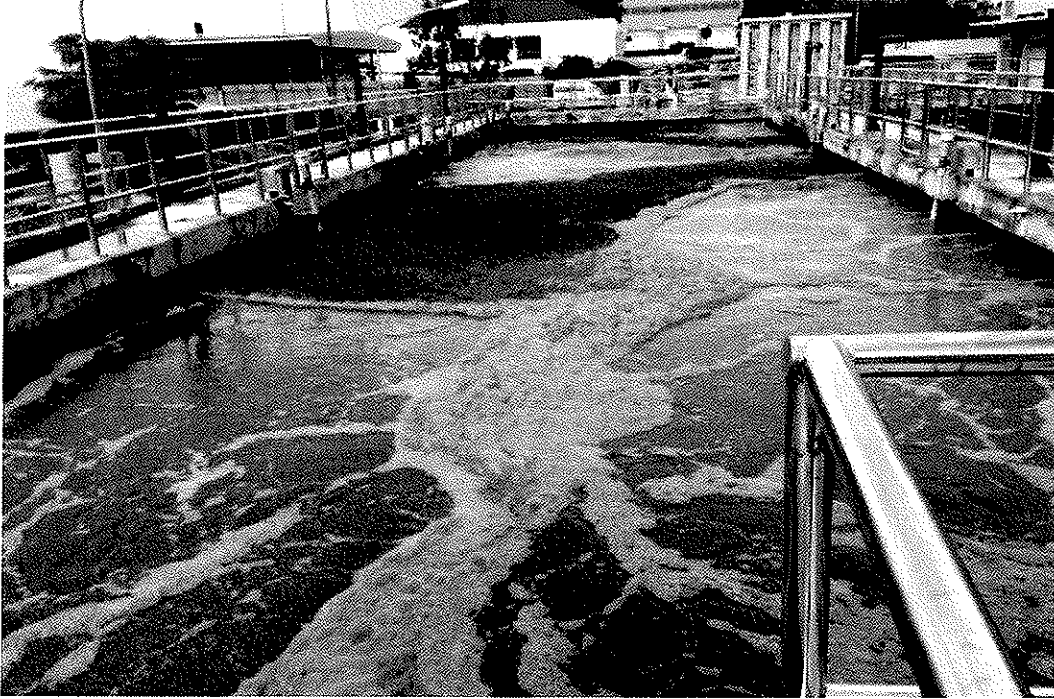
บ่อเติมอากาศ
