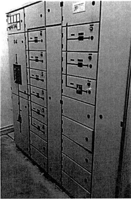
รูปที่ 15 ตู้ไฟฟ้าหลัก (Low Voltage Switch Board) ณ สถานีไฟฟ้าย่อยที่ 6 FS6(SS2-12)
