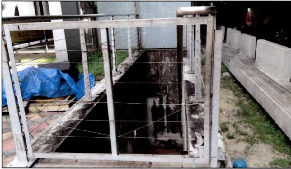
รูปที่ ก.8-3 ภาพตัวอย่างลิฟต์ที่น้ำไหลลงในห้องเครื่องลิฟต์ได้
