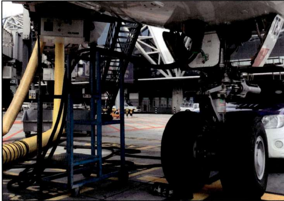
รูปที่ ก.12-5 แสดงตัวอย่างระบบไฟฟ้าภาคพื้น 400 Hz (GPU)
