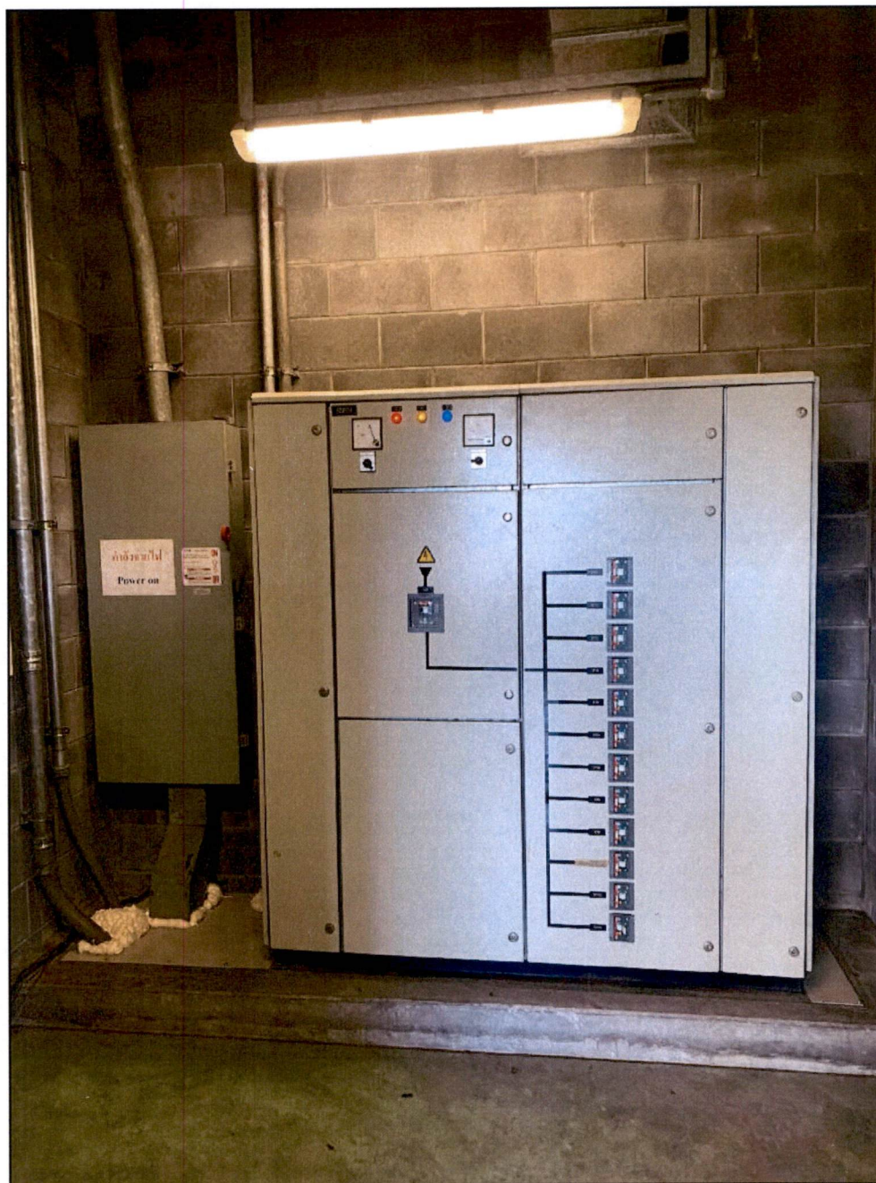
รูปที่ 3 แสดงลักษณะภายนอกของตู้ Panel Board
